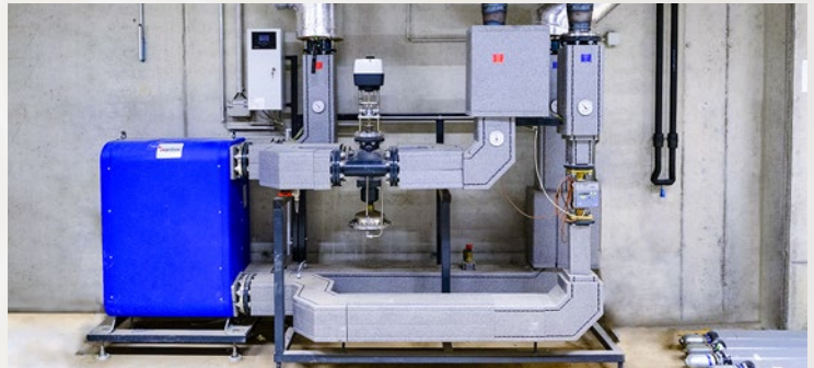
Fernwärme-Abnahmestelle mit 500 kW Leistung
